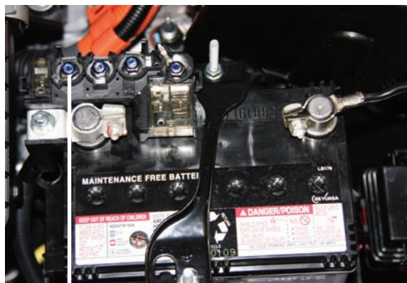
Connexion du câble du convertisseur c.c. à c.c.
